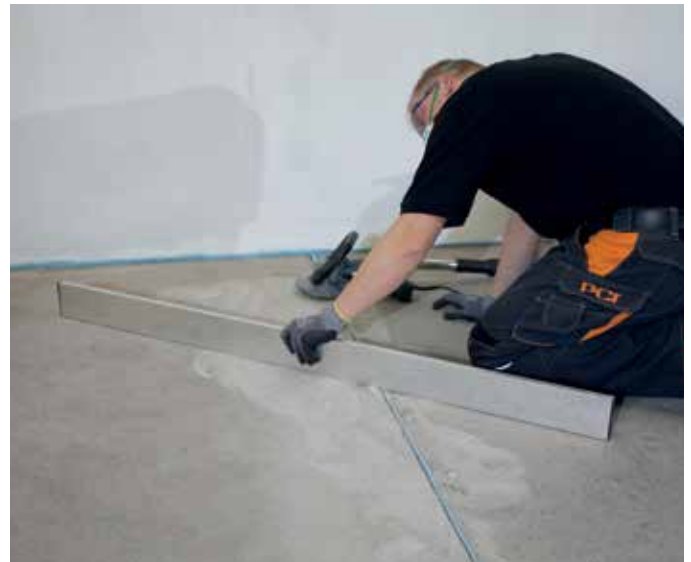
Fig. 3 – Tilladt ifølge normen, men ikke tilstrækkeligt jævnt til lægning af store formater; i det aktuelle tilfælde er en udjævning nødvendig.
